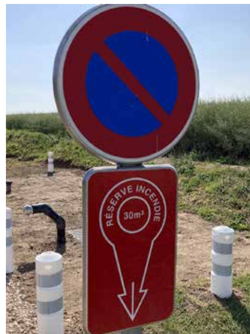
→ À Chambois, la commune a procédé à l'implantation de 4 nouvelles réserves d'eau avec le concours du Département de l'Eure, de la Préfecture et l'aide du SDIS27.
